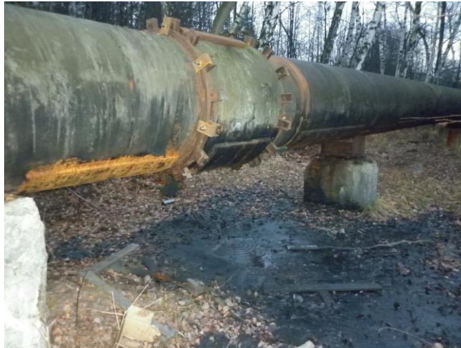
Fot. 4 przeciek (rurociąg wielokrotnie "łatany")
