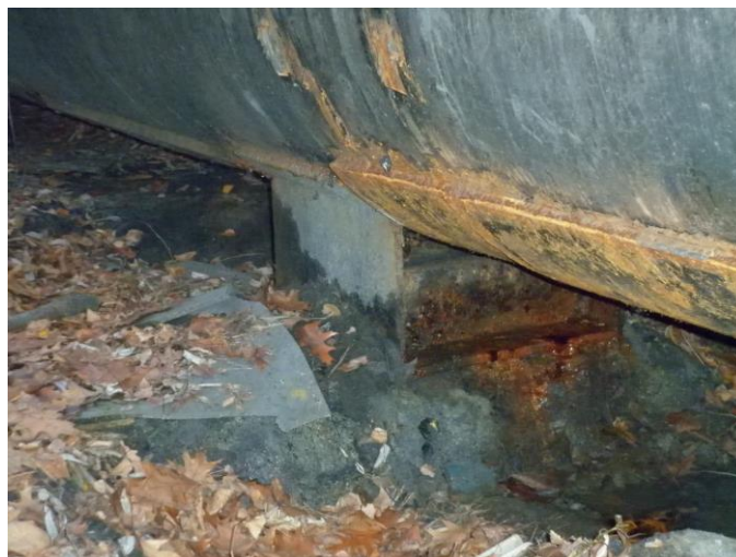
Fot. 5 przeciek w okolicy podpory
