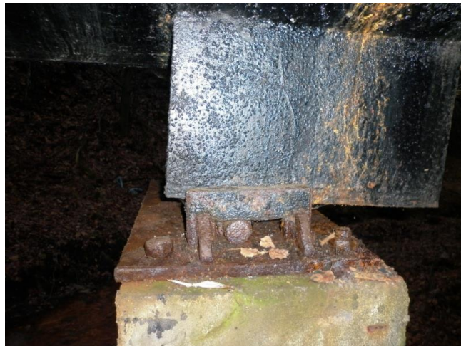
Fot. 10 istotne przemieszczenia na podporze przesuwniej
