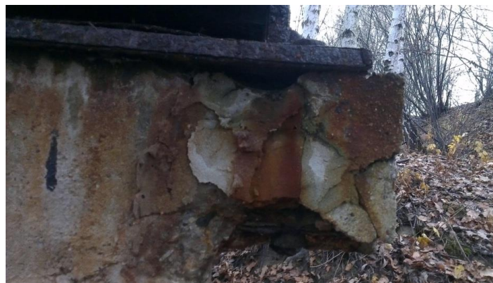
Fot. 12 korozja betonu
