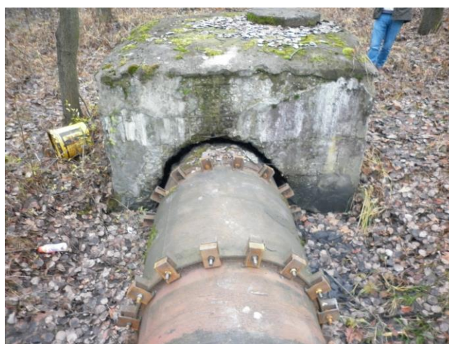
Fot. 3 koniec (studzienka żelbetowa naziemna)
