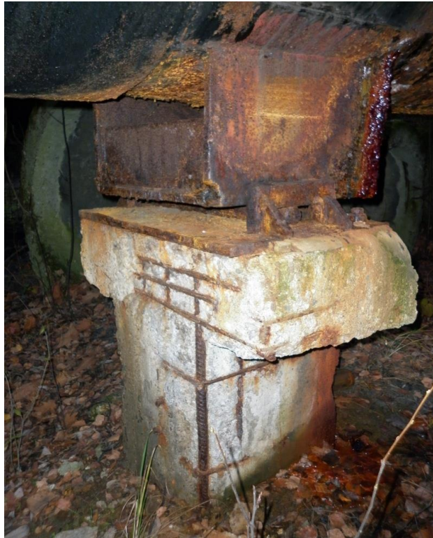
Fot. 9 podpora silnie skorodowana
